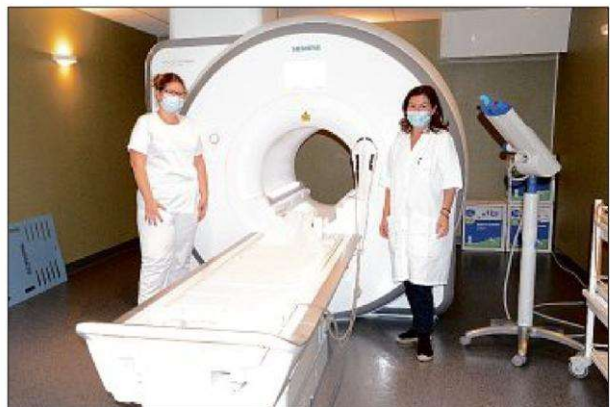
D'ici 16 mois, d'autres machines performantes vont rejoindre cette IRM déjà installée aux portes du Centre hospitalier de l'agglomération montargoise depuis 2015.
